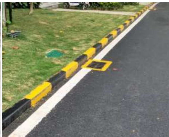
场地内部排水管网 3#
