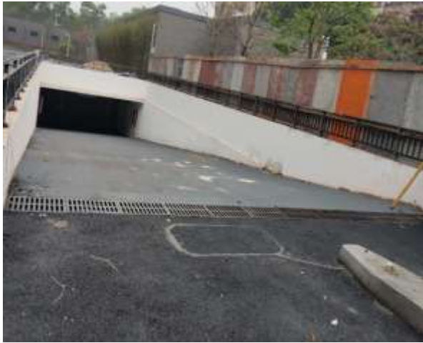
地下车库截水沟 1#
